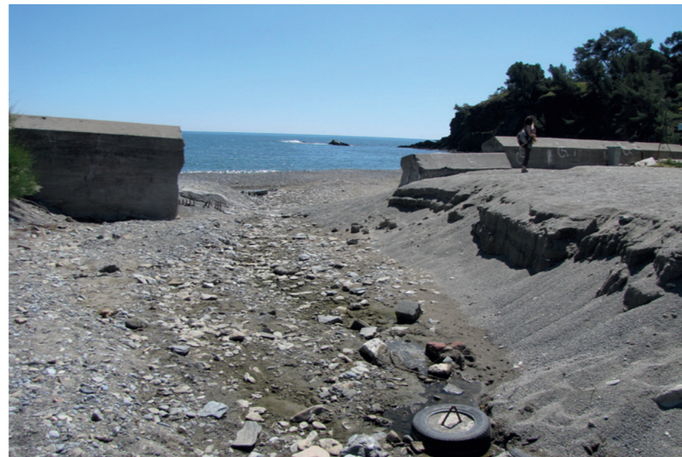
Exutoire dégradé du ruisseau centre
